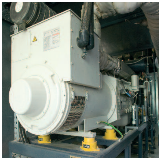
► Els motors de cogeneració produeixen energia elèctrica i calorífica a partir del biogàs obtingut en el procés de digestió.
